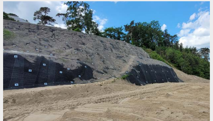
Die Bodennägel wurden in Kombination mit einem Stahlgeflecht und einer Erosionsschutzmatte eingesetzt.
